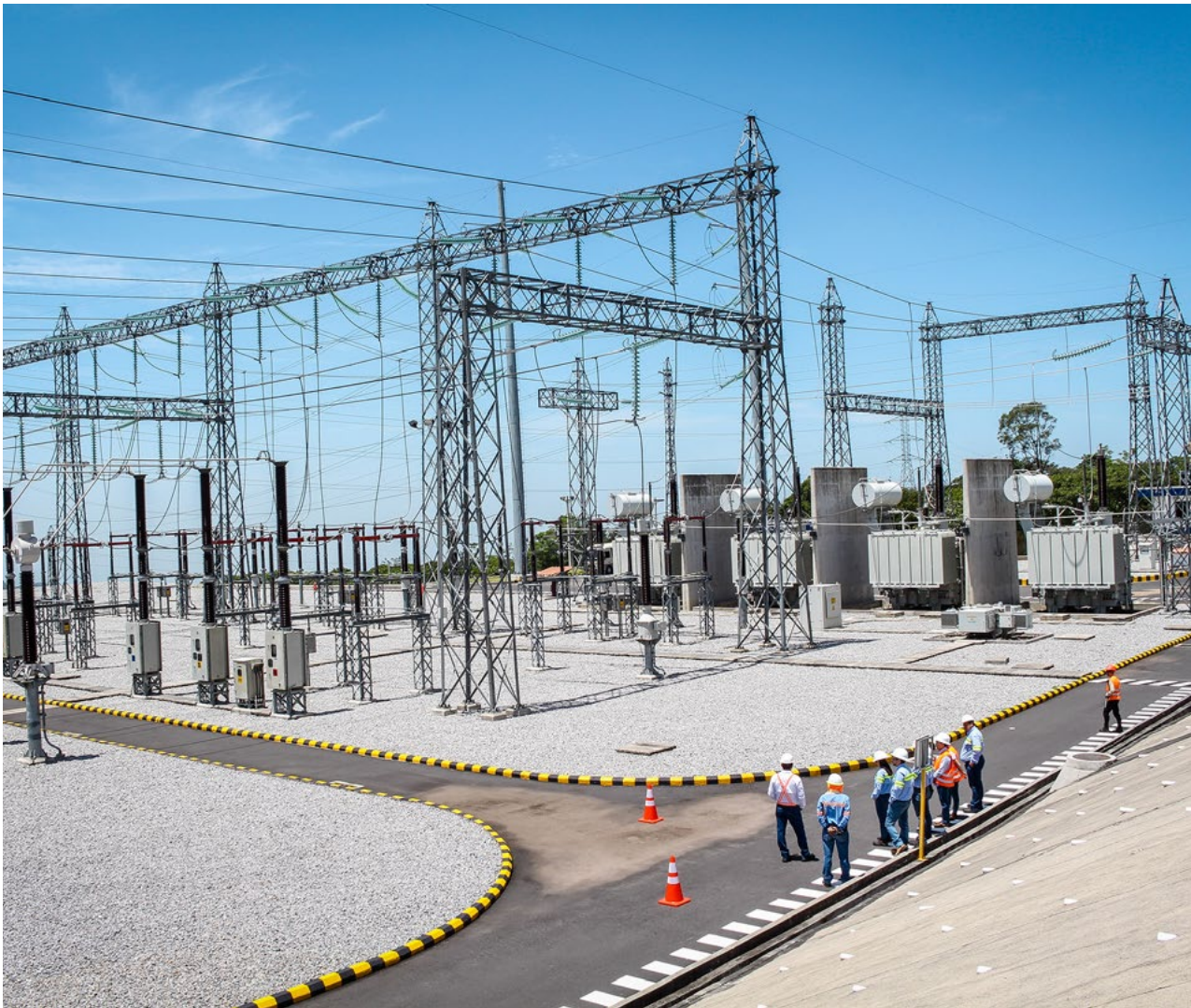
Subestación Palestina 230 kv
