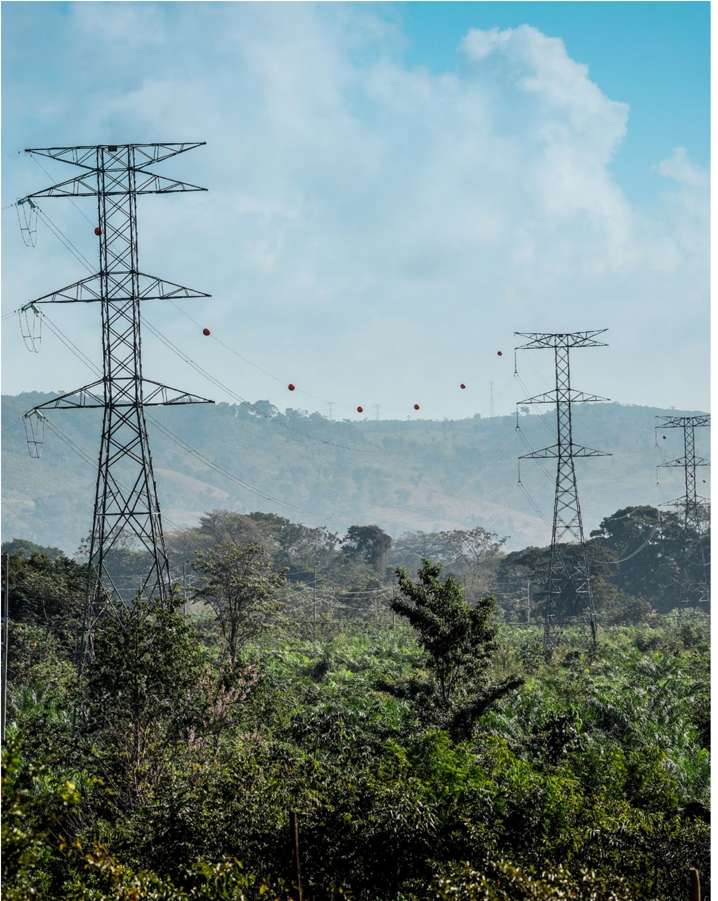
Línea de Transmisión en El Estor, Izabal
